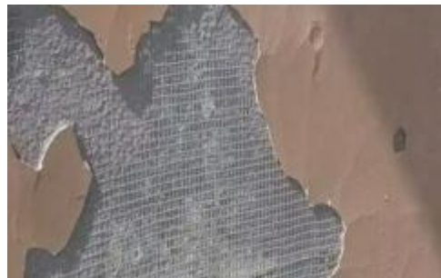
图5.10 保温浆料脱落示例
