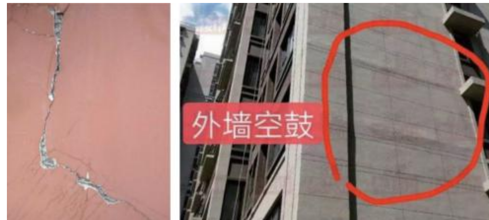
图5.12 外墙保温板开裂、空鼓
