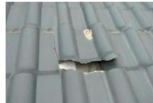
图8.6 开裂的树脂瓦
