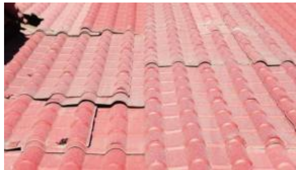
图8.4 树脂瓦开裂、变形引起漏水
