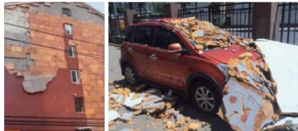
图5.11 外墙保温板脱落
