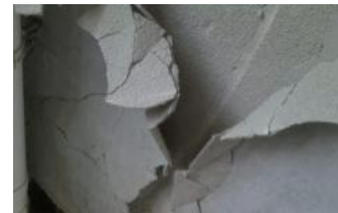
图5.9 膨胀珍珠岩内保温脱落示例
