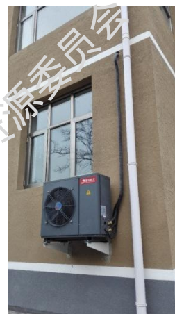
图5 空气源热泵室外机
