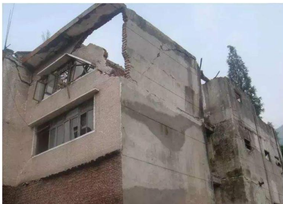
图 3-2 未设置构造柱、圈梁、未见墙体拉结钢筋，地震中破坏严重
