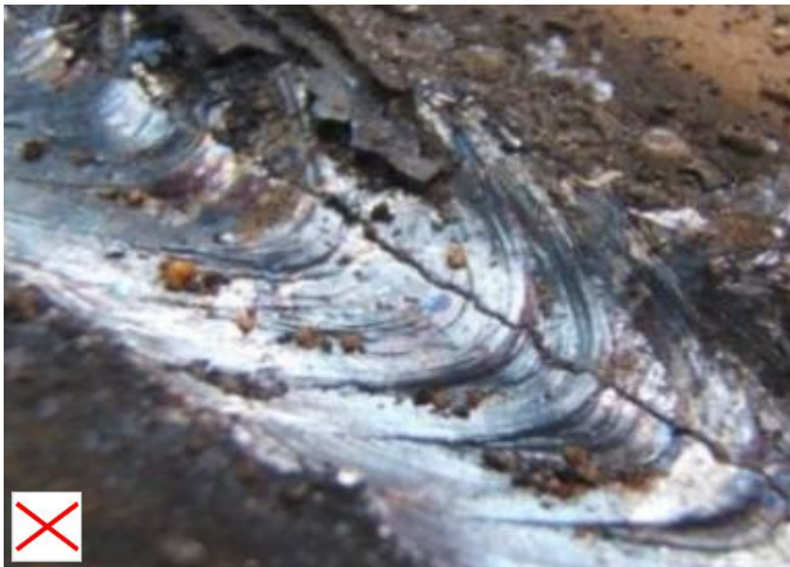
c 焊缝存在裂缝
