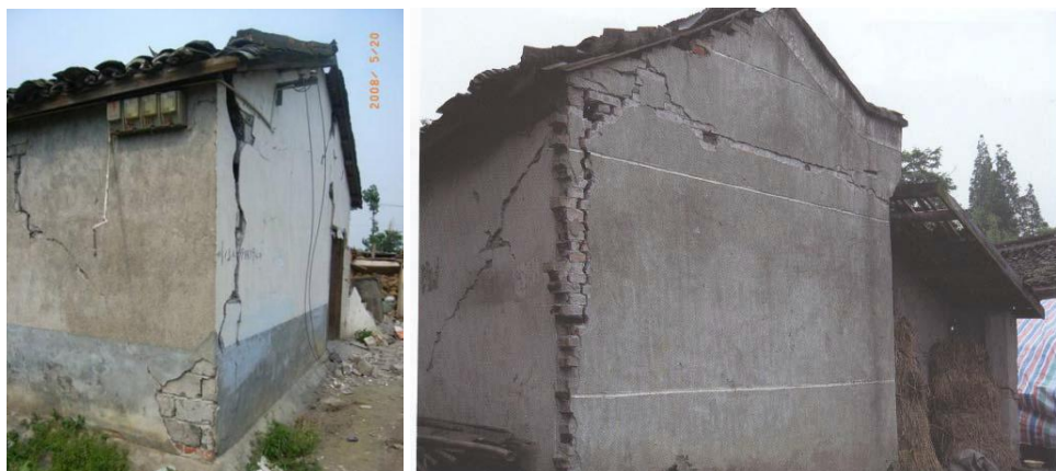
图 3-1 未设构造柱、圈梁，在地震中损坏严重
