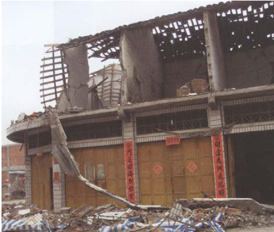
图 3-3 二层未设置圈梁、构造柱，坡屋面支撑墙体顶端无压顶圈梁
