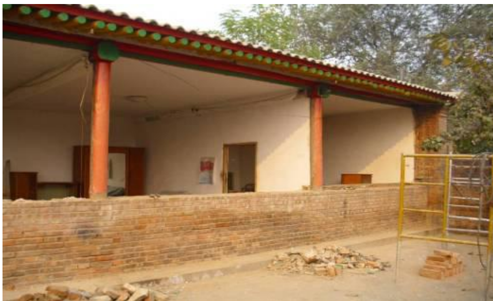
图5-2 抗震前纵墙缺失的农宅
