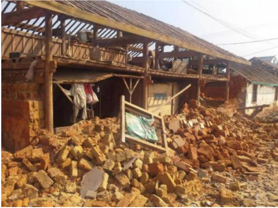
图 3-9 木结构房屋围护墙体地震时外闪坍塌
