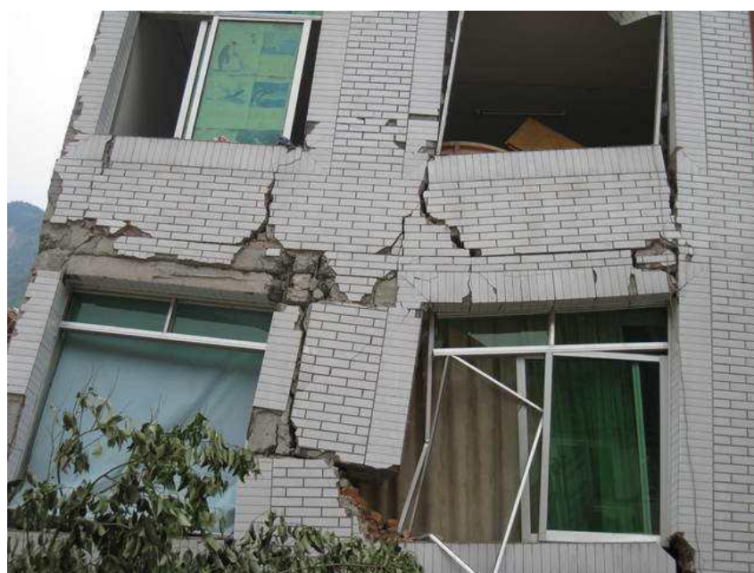
图 3-6 未设置转角墙、窗间墙抗震承载力不足
