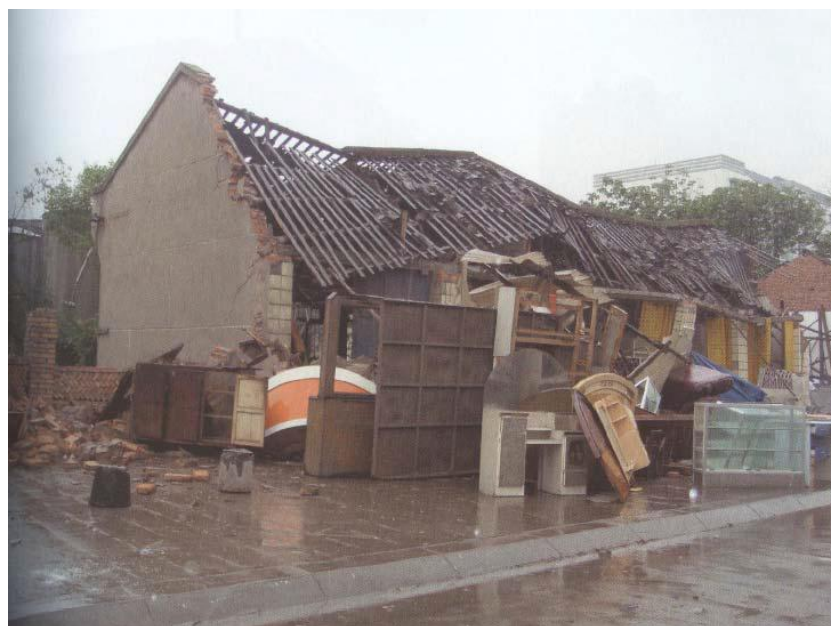
图 3-5 某一层民居震害图片
