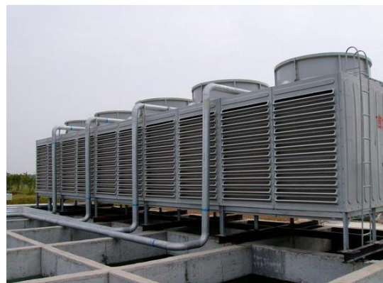
图 1-7 配多台电机冷却塔
